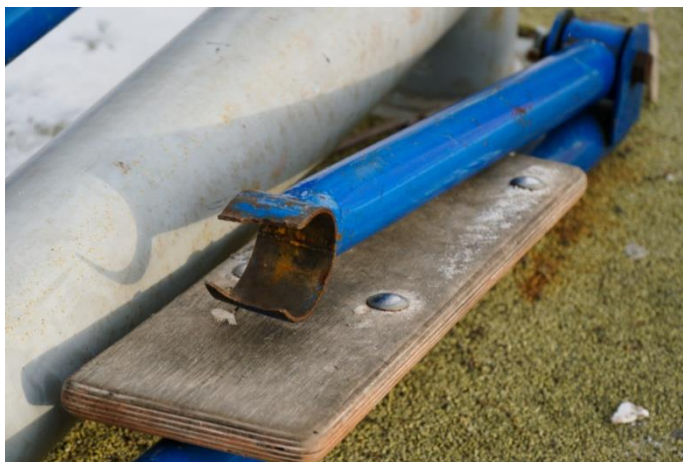
Рисунок 2. Последствия использования строительных материалов низкого качества
